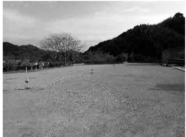
主郭盛土造成状況
